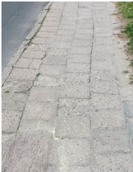
Maroder Gehweg an der Belliner Straße
