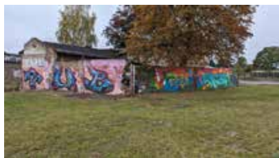
Bei der Espelkamper Straße 10 fanden Erdarbeiten für die Schaffung der Zugänglichkeit zu den Graffiti-Sprühflächen statt. Auf der Freifläche wurde eine Tischtennisplatte aufgestellt.
