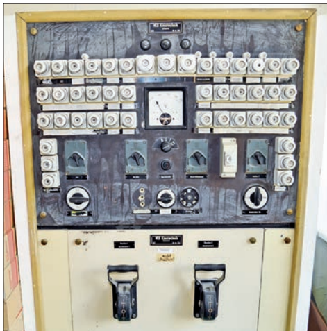
Die elektrische Sicherungstechnik für das Kino hat zwar teilweise schon Museumswert, wurde aber im Laufe der Jahrzehnte immer wieder modernisiert und ergänzt und leistet damit bis heute zuverlässig ihren Dienst. Foto: Uwe Werner
